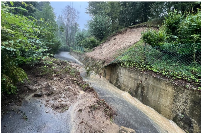
Foto – Frana settembre 2024 lungo via Donizetti
